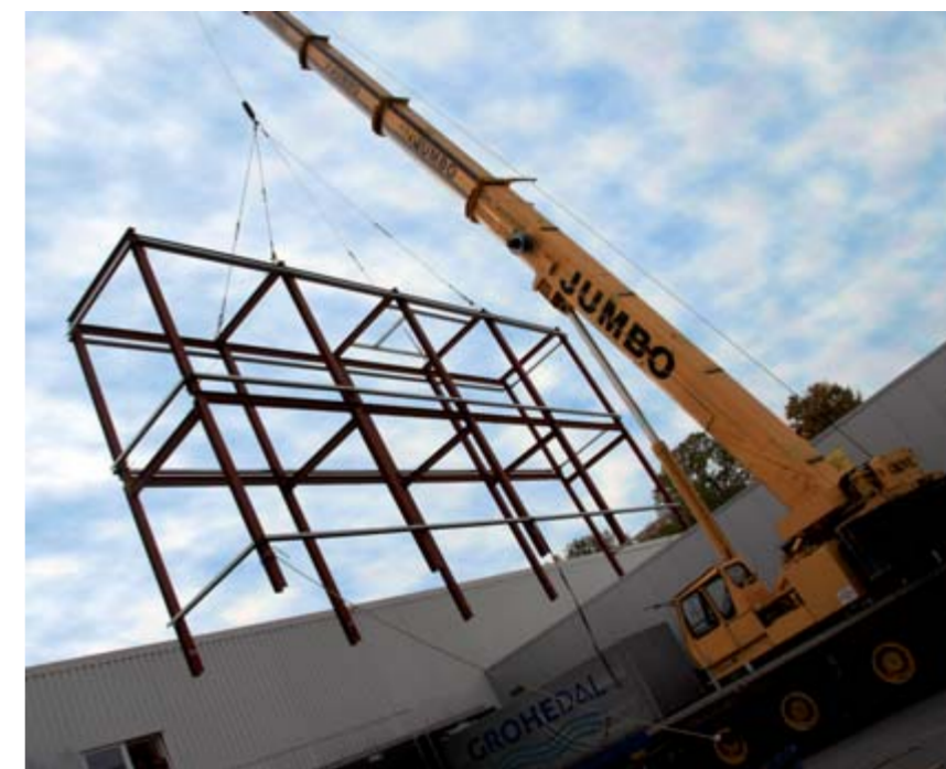
Das Hochregal-Lift-System wurde in die bestehenden Produktionsstrukturen integriert. Ein Bereich des Daches wurde abgedeckt und das Liftgerüst von oben zentimetergenau eingelassen.
