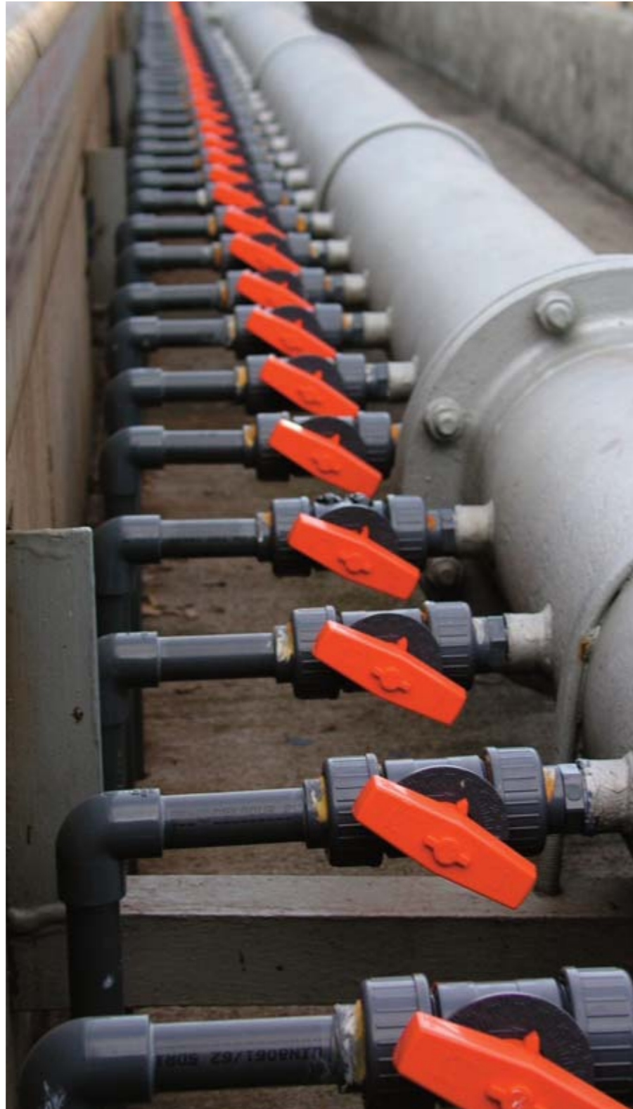
Wo zuvor ungenau einstellbare Drosselventile verbaut waren, arbeiten nun 320 ProfiDos-Dosierkugelhähne
